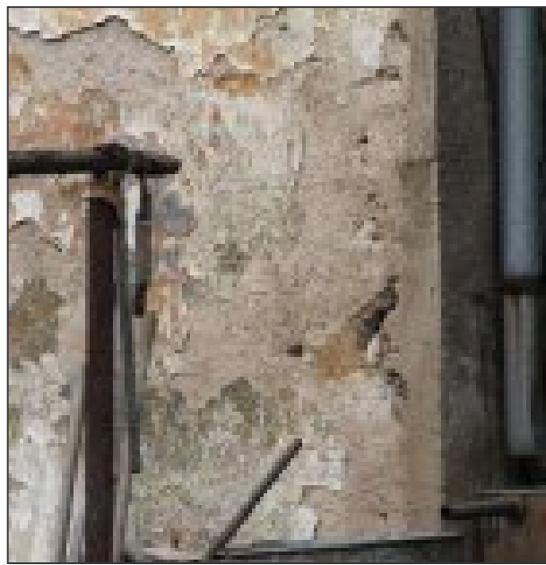
Drozdovský Jagrhauz čp. 17 – detail východního nároží se zbytkem sgrafita? (foto O. Slabý 2012).
