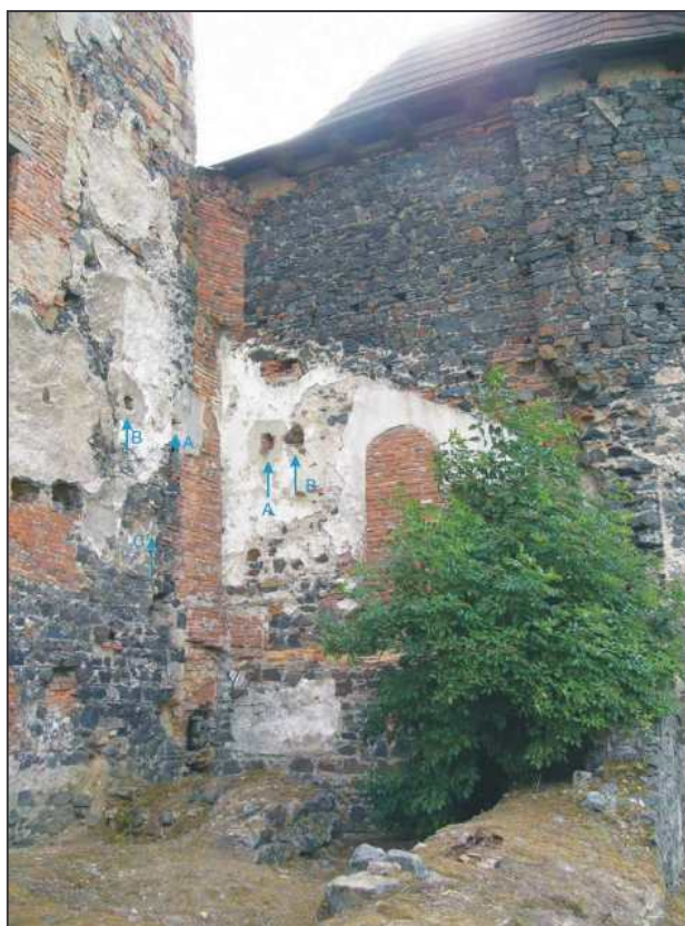
Švihov. Pohled na východní stranu Červené bašty a severozápadní nároží severního paláce. Šipkami vyznačena trnová výměna – kapsy A-A, kapsy B-B a místo odřeznutého stropního trámu C (foto 2005).
