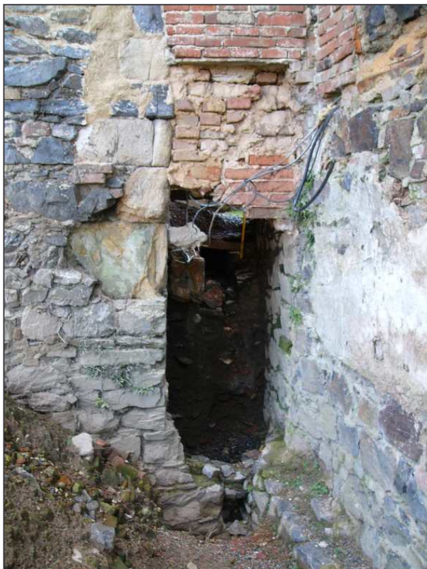
Švihov. Pohled na proluku mezi Červenou baštou a severozápadním nárožím severního paláce. Vpravo dole část před-sazeného zdiva pod baštou. Uprostřed dole zbytek zdi vybíhající z nároží paláce k baště. Pohled od severu (foto 2010).
