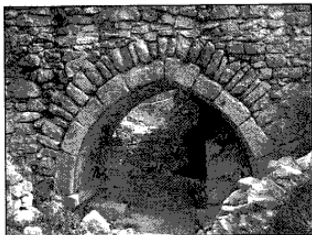
Hrad Lukov, pohled na západní průčelí jižní brány v průběhu odstraňování sutového závalu. Horní část lomeného oblouku vnitřního portálu zrušené brány, ve spodní části snímku jsou patrné horní části dvojice svislých stojek vstupního portálku do sklípku
