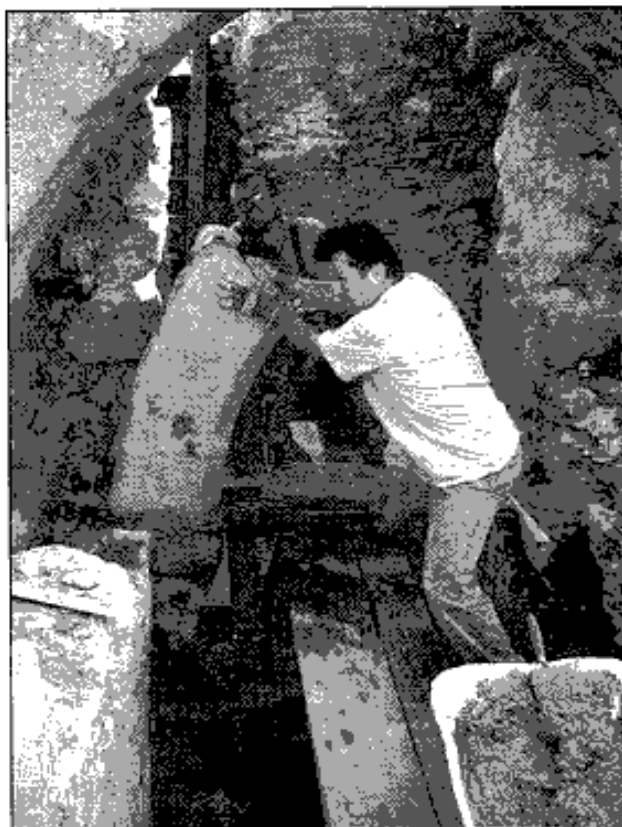
Hrad Lukov, osazení prvního bloku ostění (vpředu J. Holík, vzadu D. Juříček).
