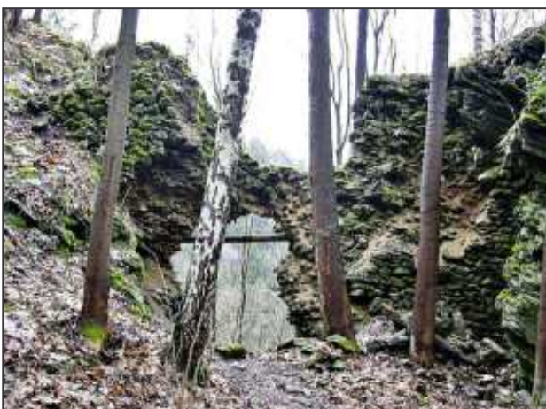
Dezolátní stav jižní strany prostřední hradby těsně před zřícením (foto P. Špráchal 2007).
