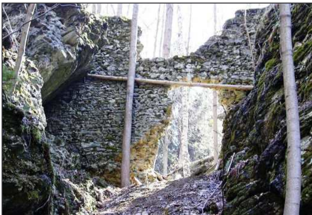
Severní strana prostřední hradby bývala kdysi provizorně vzeprěna výztuží proti zřícení (foto P. Špráchal 2004).
