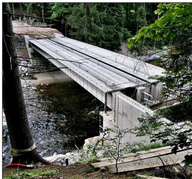
Snímek rozestavěného mostu pod hradem demonstruje výšku nad hladinou řeky (foto autor 2013).
