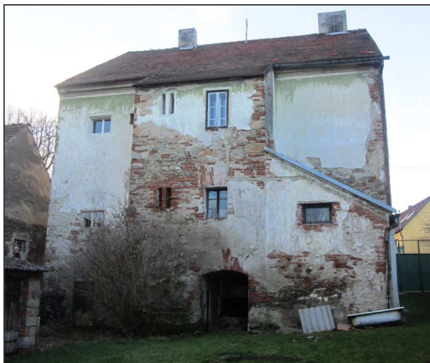
Dolejší dvůr – pohled na nádvoří stranu domu čp. 40 s rizalitem a přístavkem (foto P. Mikota 2015).
