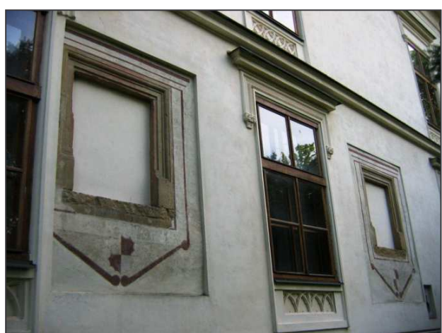
Obr. 5: Lešná (okr. Vsetín), dvojice renesančních oken s omítkovými paspartami ve vnějším průčelí severozápadního křídla, uprostřed rozměrné okno ze závěru 19. stol.
