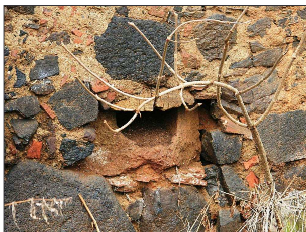
Obr. 6: Týniště, odtokový žlab – výlevka ve zdivu jižního křídla dvora (foto L. Krčmář 2008).
