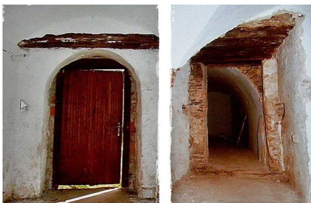
Zleva: Dubový překlad z valdštejnské přestavby datovaný do let 1420-1437. Zazděný gotický průchod, dendrochro-nologicky vrocený do let 1421-1433 (foto J. Pešta 2011).
