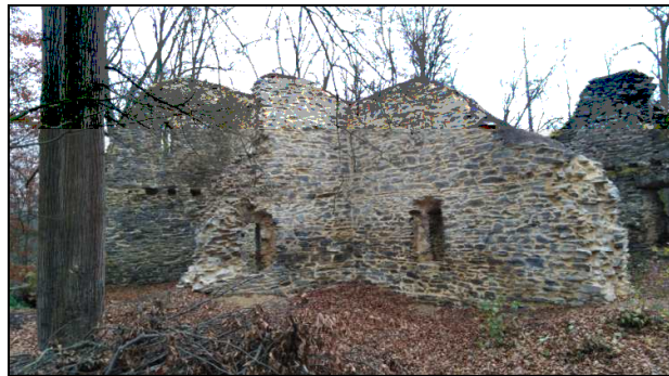
Karlův Hrádek, opravené zdivo v jihovýchodním nároží hradního areálu (foto P. Mikota 2021).
