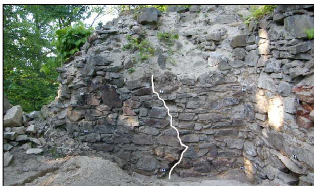
Obr. 4: Rýzmberk – zvýrazněná spára na vnitřním líci severovýchodní zdi tzv. starého paláce dokládající složitější vývoj této části dispozice. Jedná se pravděpodobně o přezděný fragment původní obvodové hradby jádra hradu – pohled od jihozápadu (foto P. Kausek 2015).
