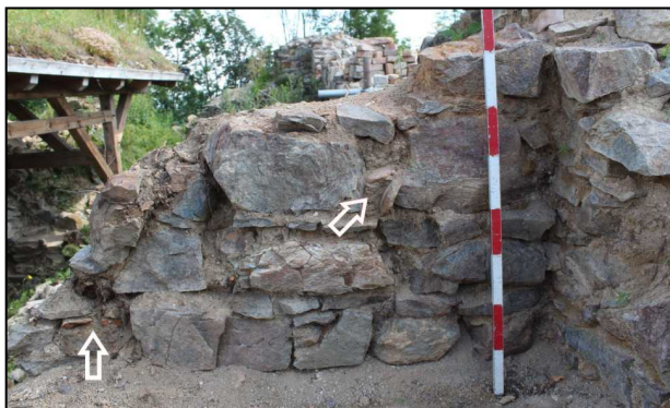
Obr. 5: Rýzmberk – jedna z příček tzv. starého paláce, která je přizděna na spáru k jihovýchodní obvodové zdi. Šipkami označeny zlomky prejzů použitých ve zdivu – pohled od jihozápadu (foto P. Kausek 2019).
